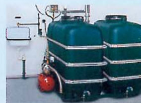
Des cuves pour récupérer l'eau de pluie.
